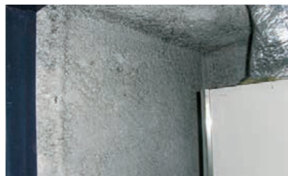
▲アスベストの現場
